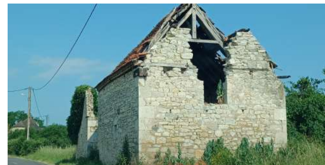
Bâti en pierre dégradé
