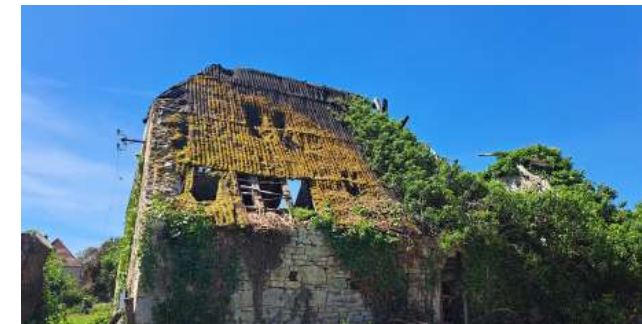
Habitation ancienne en péril d'effondrement
