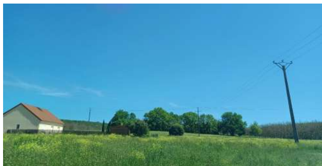
Lignes électriques qui traversent le site
